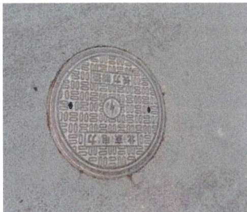
场地内电力井情况
