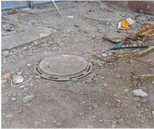
场地内排水井情况
